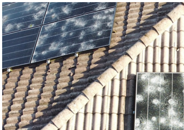
2. Danni all'impianto fotovoltaico
