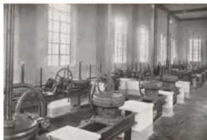
Interno dell'edificio di presa. Macchinario per il sollevamento elettrico delle paratie
